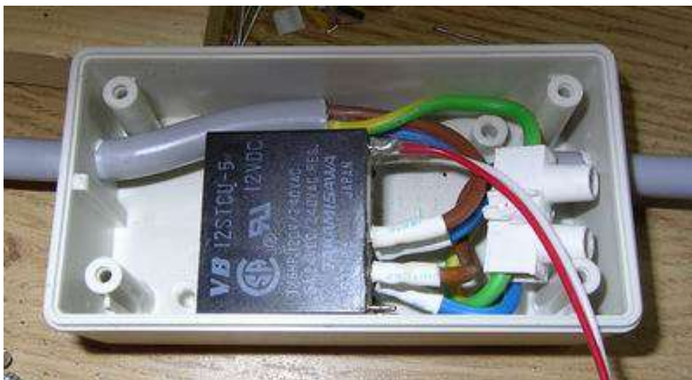
Innsiden av 220V kontaktrele.
